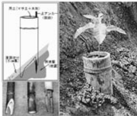
第3図 縦型竹筒の切り口と緑化の設置手順 左上: 岩盤吹付法面の設置手法、左下竹筒切り口各種 右: 竹筒設置後苗木植栽
