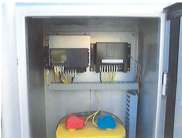
(1) バッテリーボックス及びコントローラー
