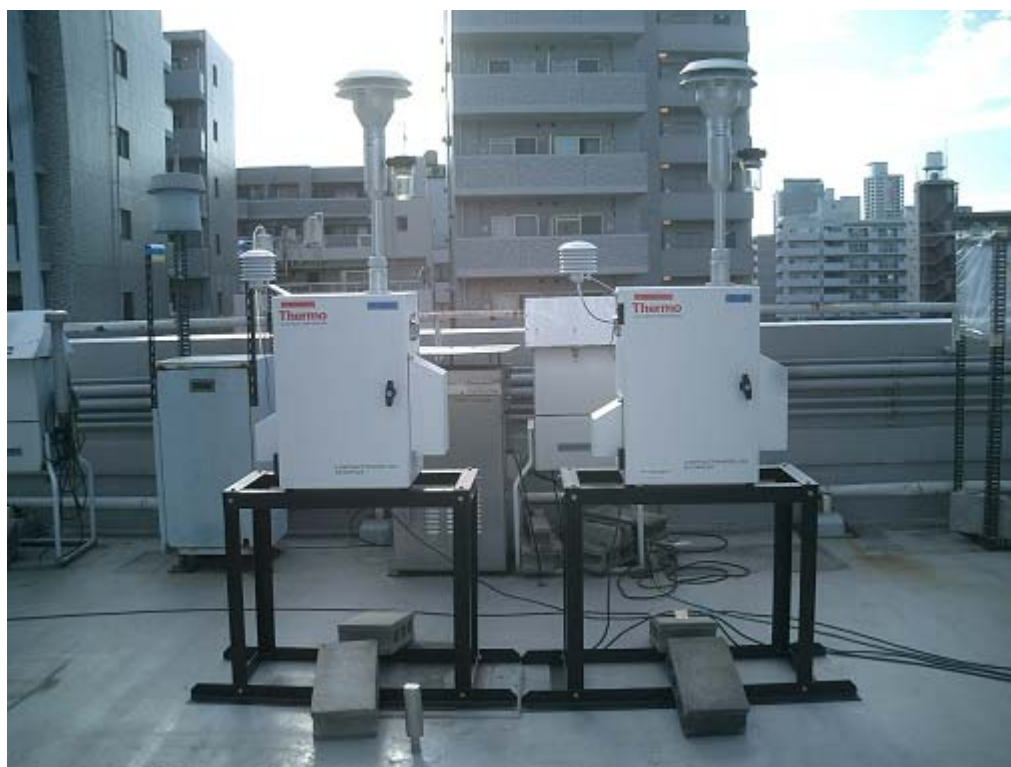
図 2.1-1 捕集機器設置状況
