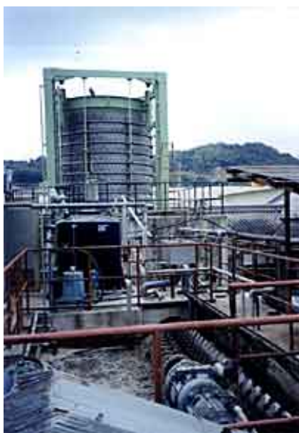
第1図 昭和60年度に建設された日本で初めての豚ふんと食品残渣を原料とするメタン発酵施設(大阪府泉佐野市)
