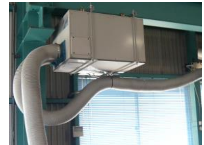
スポット式エアコン
