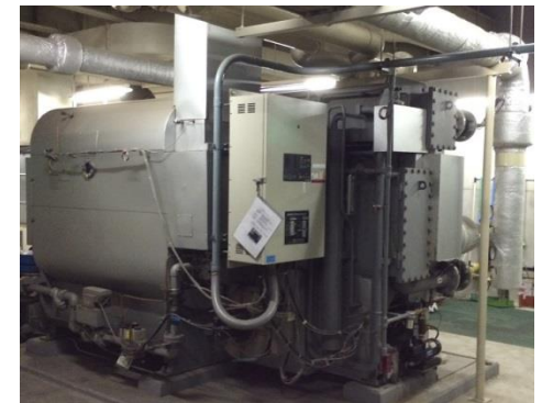
吸収式冷温水機
