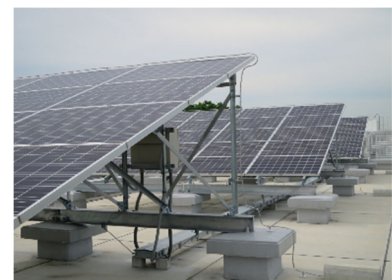
新棟の太陽光パネル
