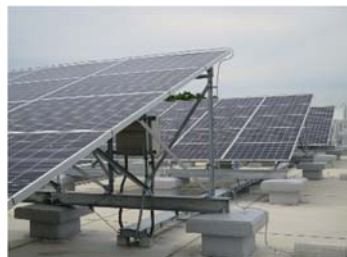
新棟の太陽光パネル
