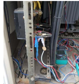
電力計測の様子
