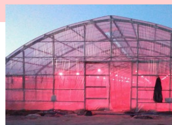
赤色LED防除装置を設置した施設
