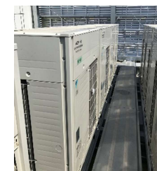
高効率エアコン(室外機)
