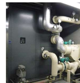
吸収式冷温水機
