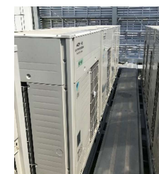
高効率エアコン(室外機)
