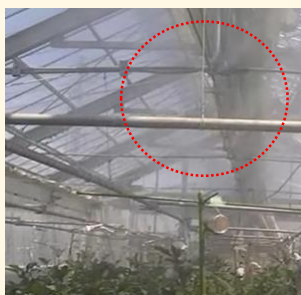
細霧冷房システム
