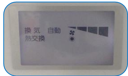
全熱交換器コントローラ画面例
