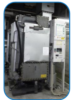
吸収式冷温水機
