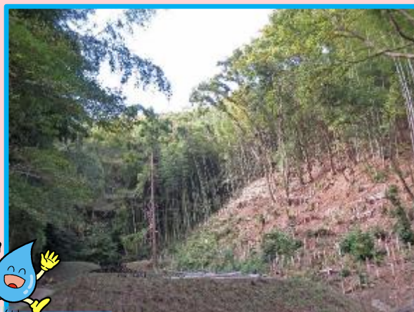
通行の支障となる竹林を整理（北河内）
