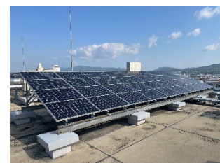
南棟の太陽光パネル
