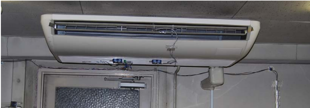
図 2.17 エアコン周りの設置状況
